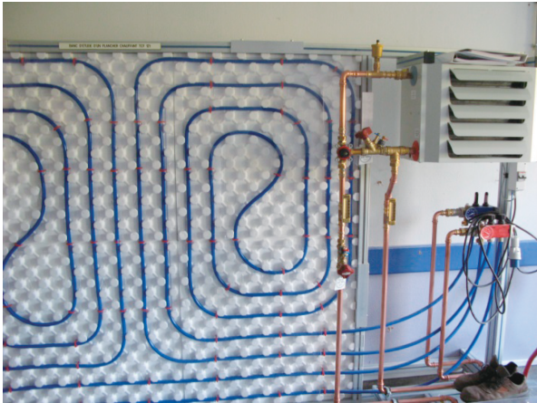
写真6 CFAの配管作業訓練室
