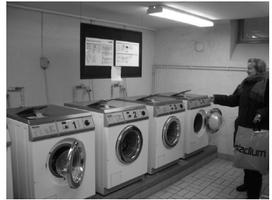
写真3 共同洗濯場に並ぶ洗濯機
