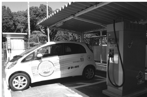
市営駐車場に設置された急速充電器 50kW
