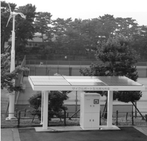
茅ヶ崎市公園内野球場脇に設置された充電システム
