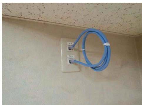
図8 アクセスポイント増設用のデジーチェーンLANコンセント
