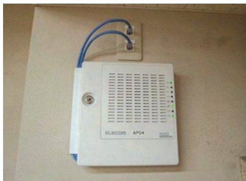
図7 アクセスポイントが設置されたデジーチェーンLANコンセント
